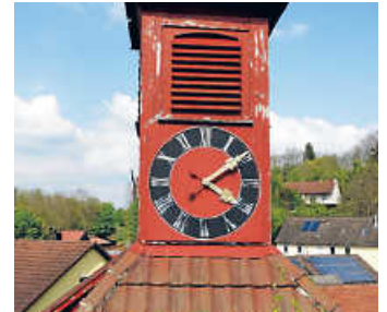
Während des Umbaus muss die Rathausuhr und Glocke vorübergehend außer Betrieb gesetzt werden Fotos: Stadt Öhringen
